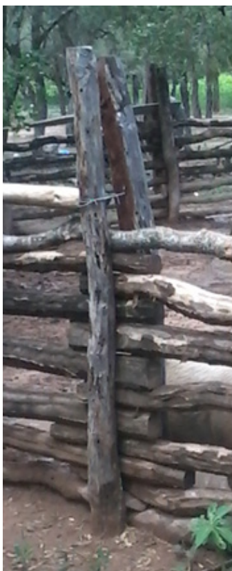
Imagen núm. 7 Columna esquinera construida con tres postes de quebracho colorado. Fotografía correspondiente a la estructura del chiquero ya construido
